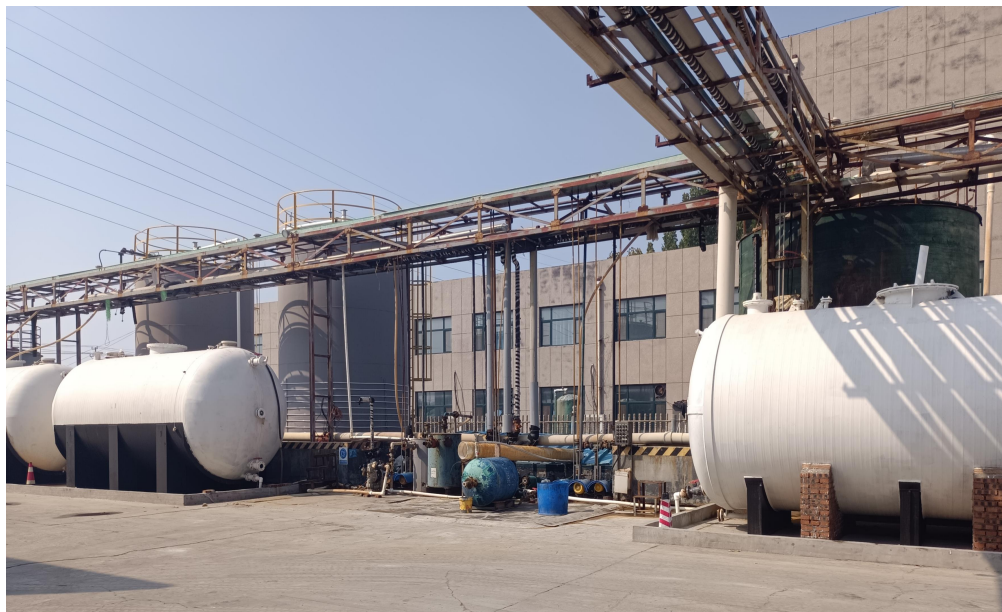
图 3.4-3 不同硫酸储罐至混合器之间的输送管道及阀门照片
