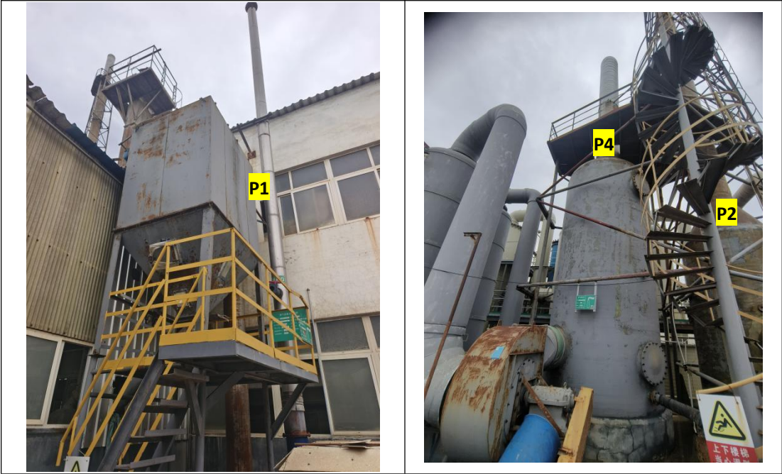
图 4.2-3 排气筒环保处理设施照片
